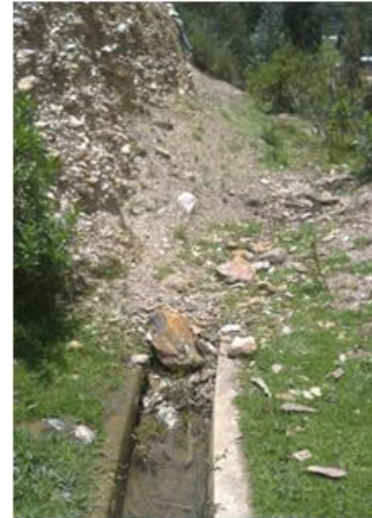
Línea de conducción principal -Huasapampa expuesta a deslizamientos. La foto muestra como luego de este evento se obstruye el canal (PER Plan MERISS, 2013a).
