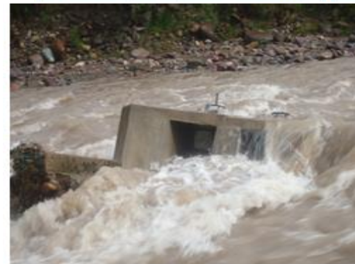
Sistema de captación Lanthahui - Bocatoma colapsada (PER Plan MERISS, 2013a).
