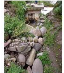
Línea de conducción principal de Llave obstruida a la salida de la captación por derrumbe de rocas (PER Plan MERISS, 2013a).
