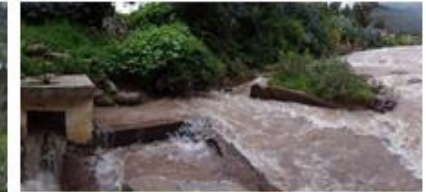
Bocatoma Llave deteriorada y expuesta al incremento del caudal del río Pitumarca. (PER Plan MERISS, 2013a).
